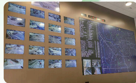
交通管制センター
