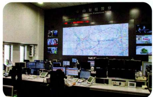
交通管制センター
